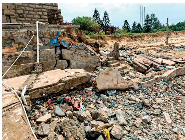
图9 福建省平潭综合实验区裕藩码头受损
