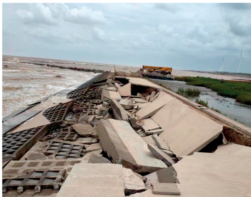
图14 江苏省盐城市射阳县海岸防护工程损毁
