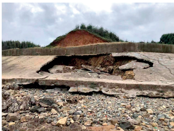
图23 福建省平潭综合实验区后垵村护岸受损 拍摄时间：2023.9.6 坐标：25°40'N，119°36'E
