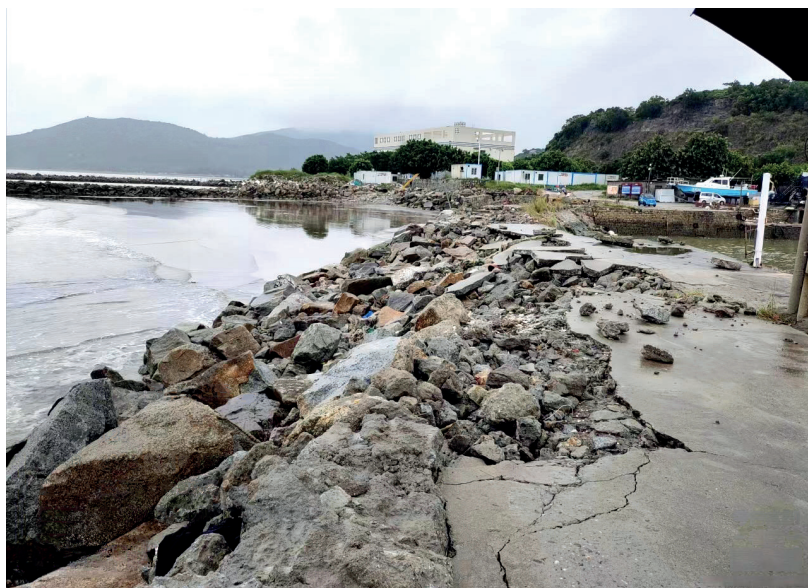
图5 广东省珠海市金湾区金海东路护岸受损
