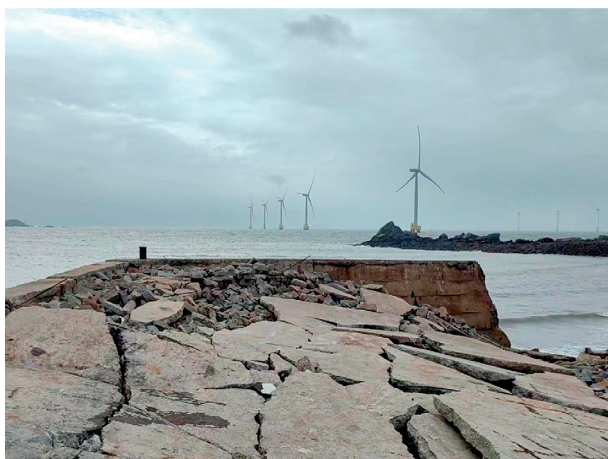
图18 福建省平潭综合实验区白沙村海堤受损 拍摄时间：2023.9.3 坐标：25°40' N, 119°48' E
